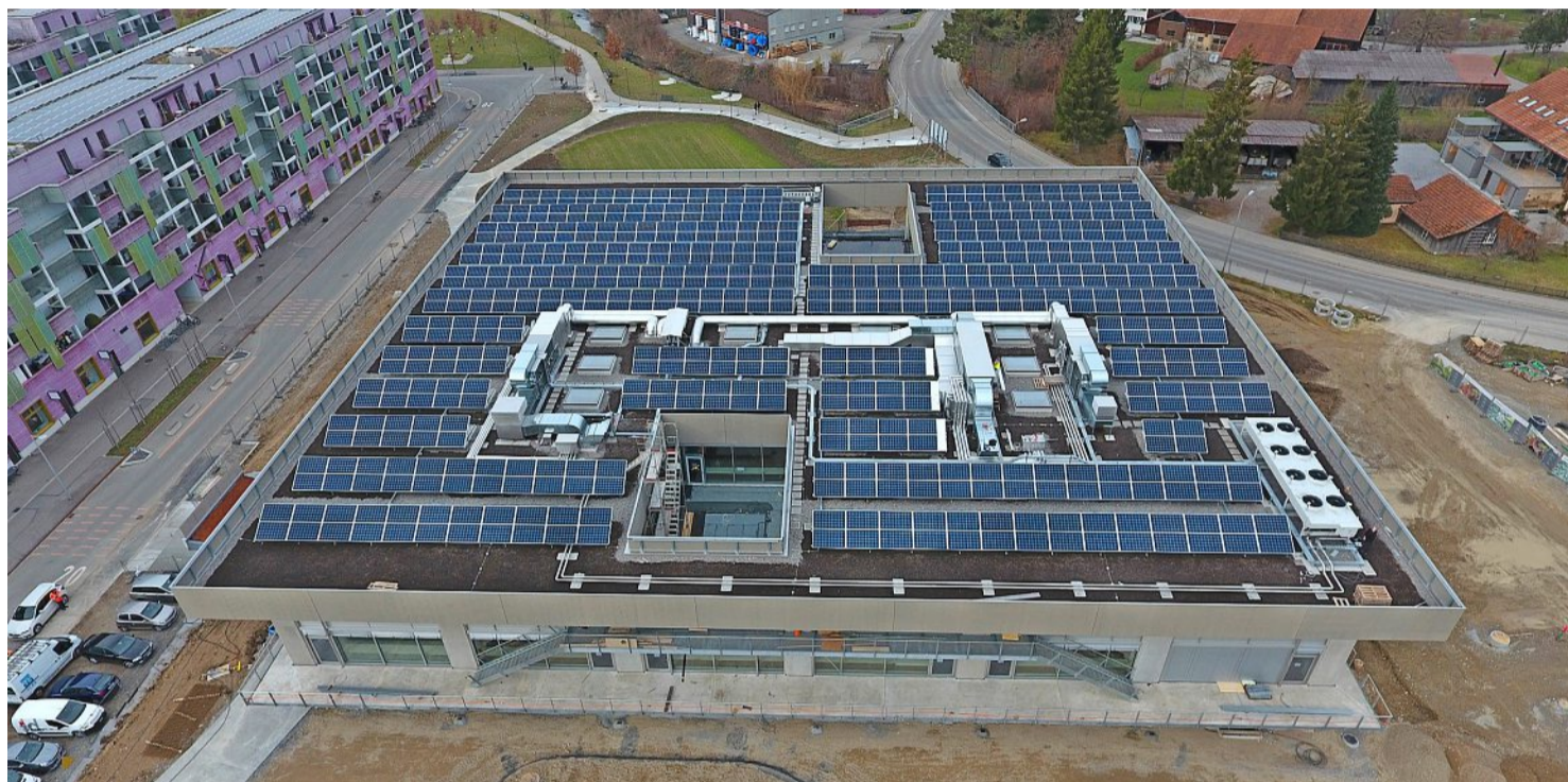
Auf dem Schulhaus Neuhegi wurde eine Fotovoltaikanlage gebaut. Damit erfüllt das Schulhaus den Energiestandard 2019 bereits. Foto: M. Schoder
